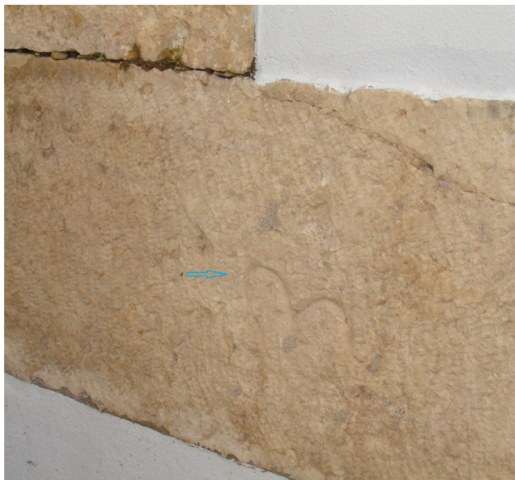
Sigla de canteiro/pedreiro, localizada na silharia do troço do Aqueduto de Loures localizado nas traseiras da Casa do Professor do Concelho de Loures.
